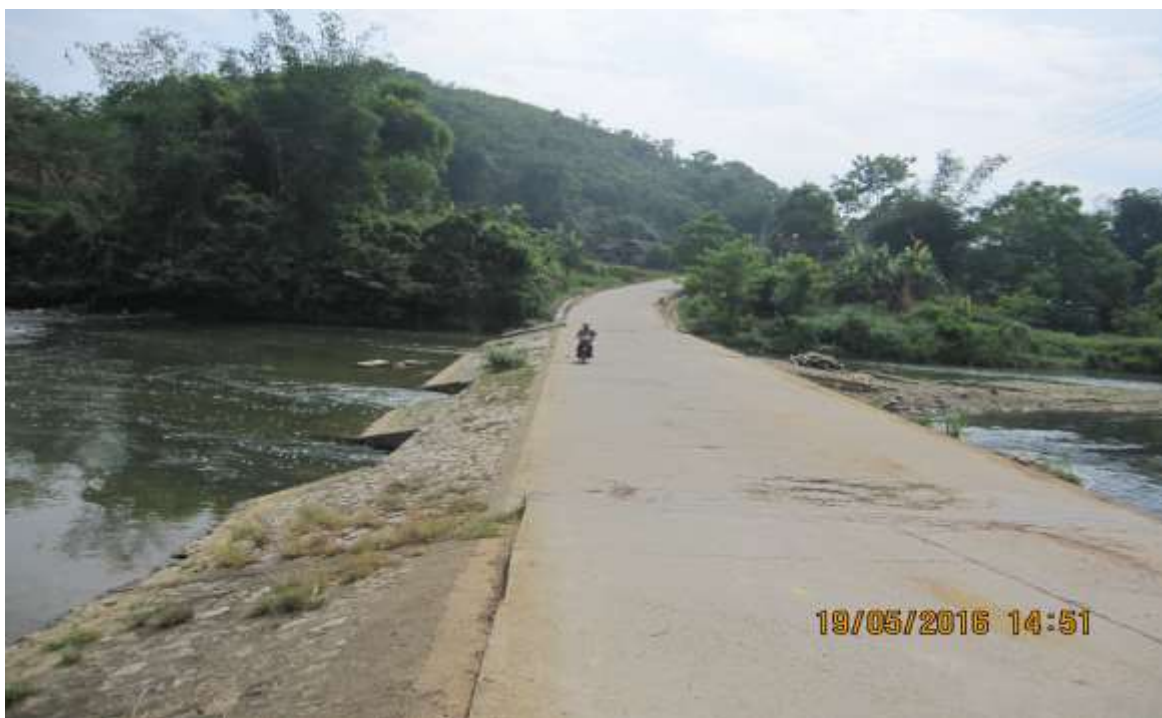
Ảnh 4: Đập tràn qua suối vào xã Kiệt Sơn (Nơi thường xuyên bị chia cắt giao thông mùa mưa lũ)
